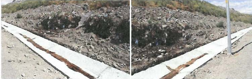
Fotoğraf 3. Depolama alanından kaynaklanan akışa geçebilen şıra oluşumu.
